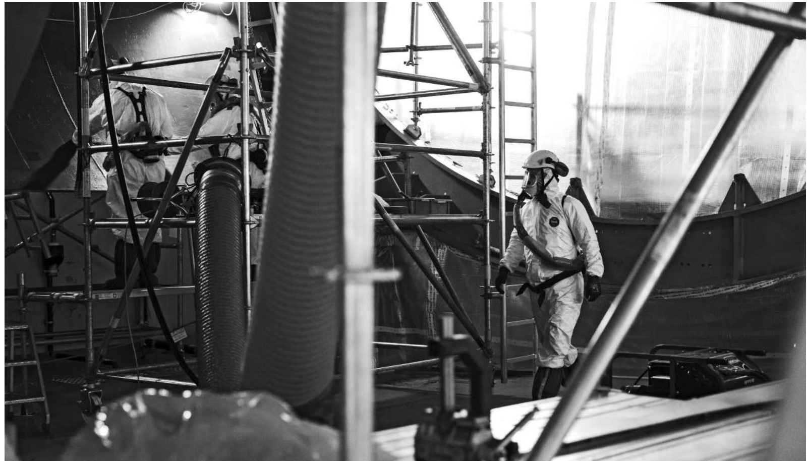
Démantèlement de la centrale nucléaire de Mühleberg, mai 2022. Les travaux de désaffectation sont prévus jusqu'en 2034. KEYSTONE
