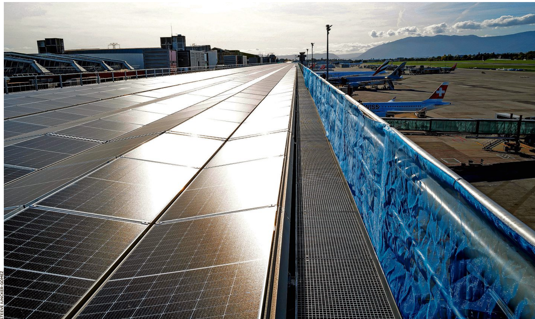
Les panneaux, qui couvrent une surface de 6700 mètres carrés et produiront 1,5 gigawatt d'électricité par an, ont été posés sur le toit de la nouvelle Aile Est.
